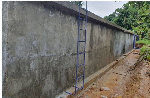
ถังเก็บน้ำ ความจุ ๑๐๐ ลูกบาศก์เมตร
